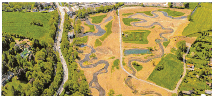
Das Luftbild zeigt gut, wie die Renaturierung der Röhrl (links) und der Sorpe (rechts) zwischen Hachen und Sorpensee verläuft.
